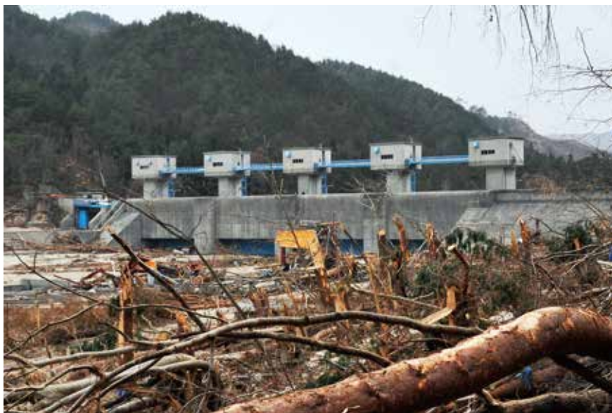
津波の威力で破損しながらも、普代地区の津波被害を最小限に抑えた高さ15.5mの普代水門
